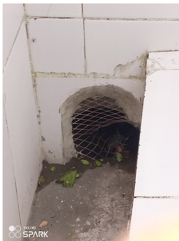
Grillage d'évacuation de l'urine endommagé
