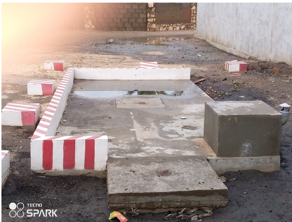
Fosse septique du bloc sanitaire
