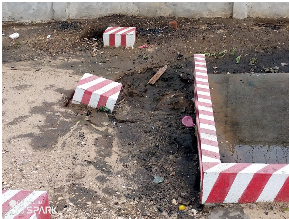
Affaissement aux abords de la fosse après passage du cyclone
